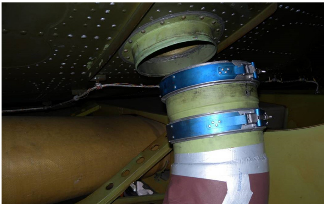
圖 2-11：脫落之 3 號空調機空調管
