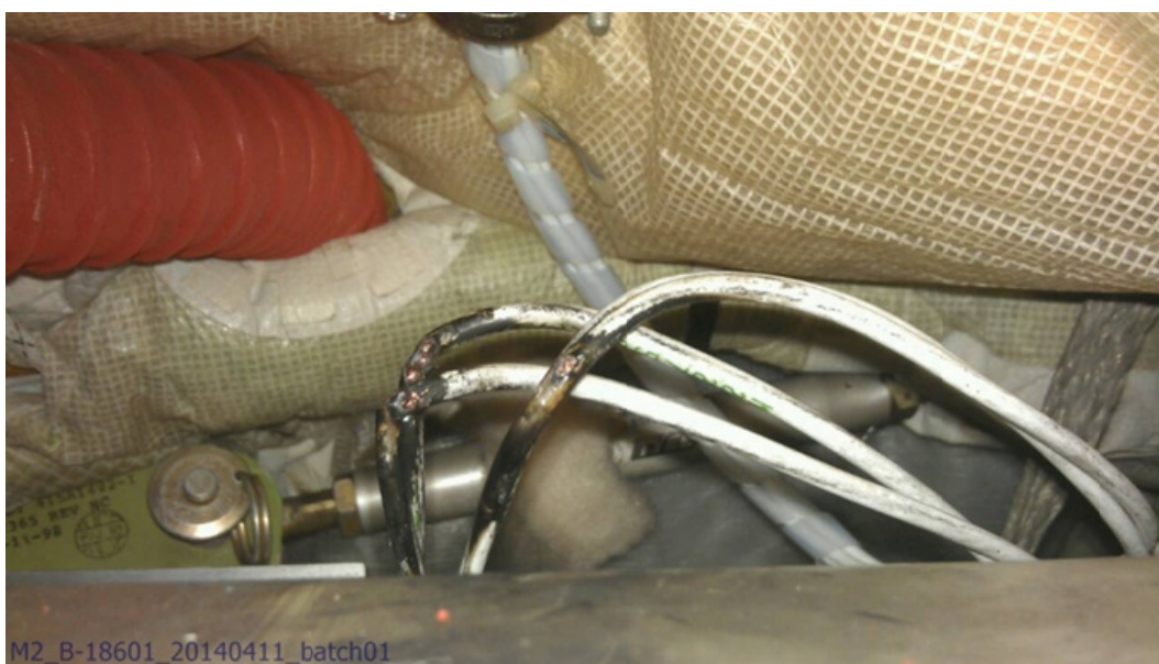
圖 2-3：電線損毀情形
