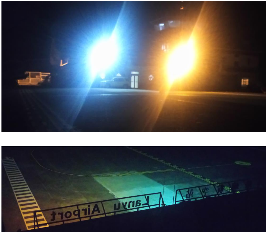
圖 1.10-4 蘭嶼機場停機坪照明燈及塔臺
