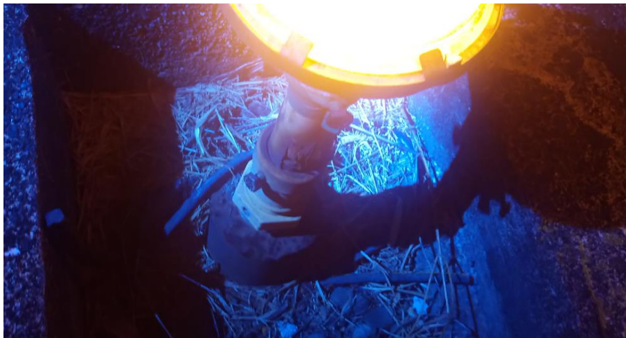
圖 1.10-3 蘭嶼機場直昇機降落區周邊燈
