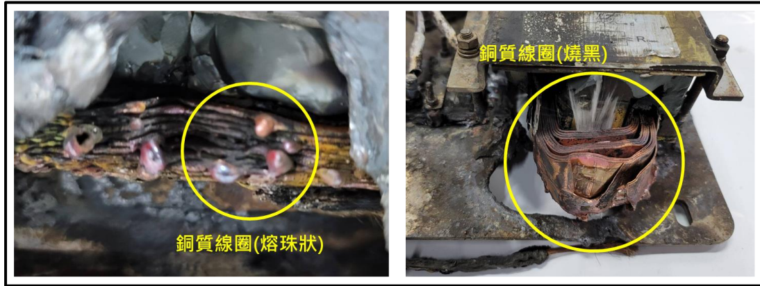
圖 1.10-5 DC-DC 模組內部碳渣堆積情形及銅質碎片
