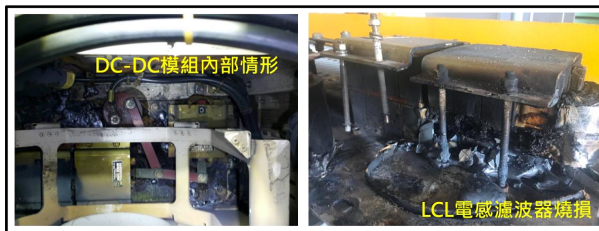
圖 1.14-1 民國 107 年電感電容濾波器燒損相片-1
