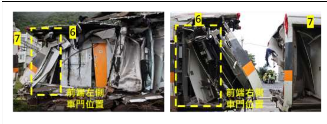
圖 1.13-11 第 6 車前端左、右側車門及玄關通道
