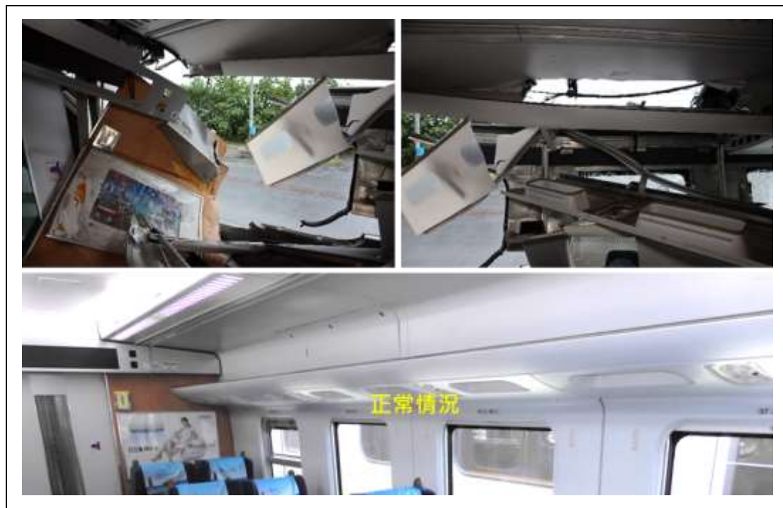
圖 1.13-20 第 7 車後端左側受損情形
