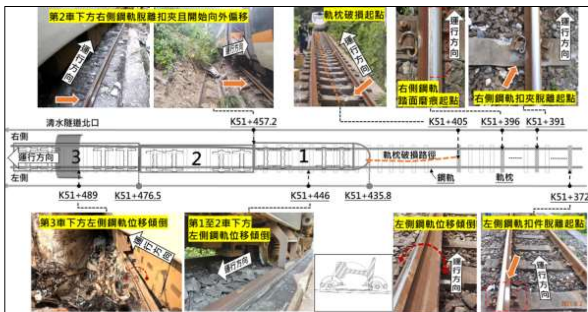
圖 1.3-9 清水隧道外軌道損害情形
