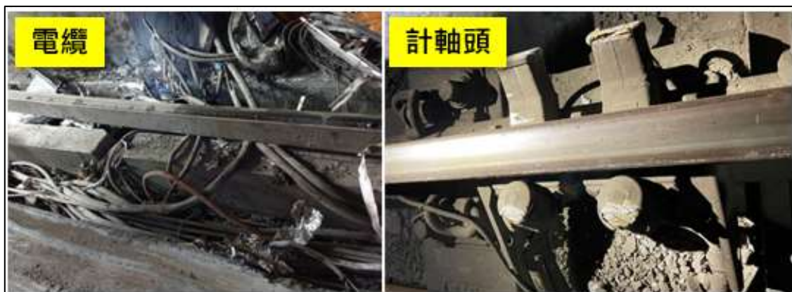
圖 1.3-16 電纜及計軸頭損壞情形
