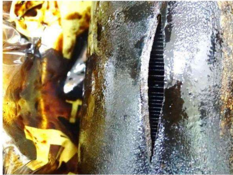
照片五：2號發電機回油端減震器斷面呈現快速破壞形貌
