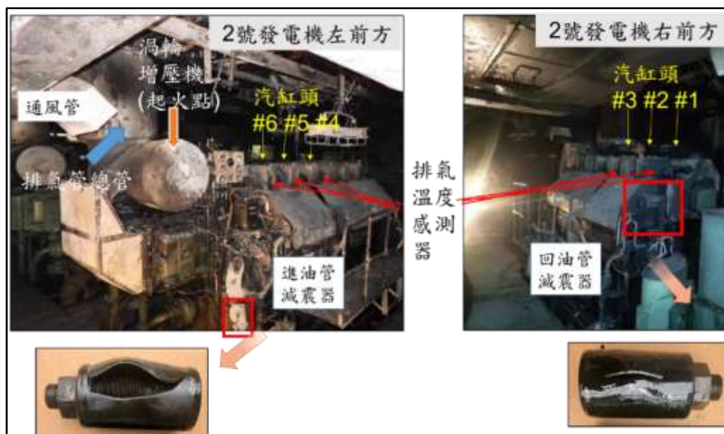
圖 2 達和 2 號發電機火災受損外觀圖
