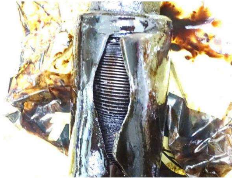
照片四：2號發電機進油端減震器斷面呈現快速破壞形貌
