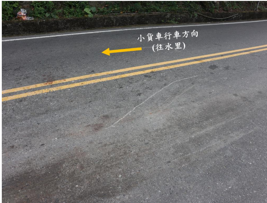
圖 1.10-3 路面刮地痕跡
