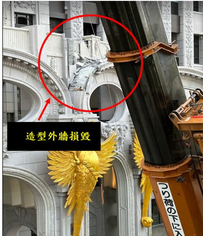
圖 1.1-12 位於低層樓之造型外牆受損
