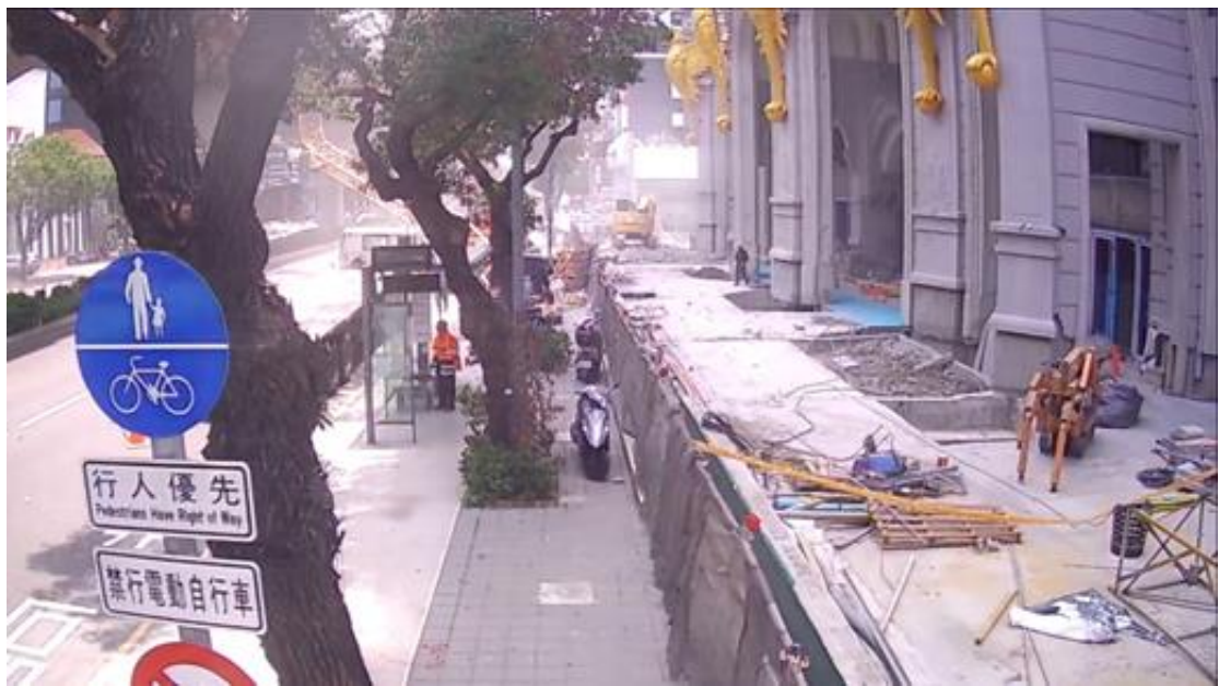
圖 1.6-8 桁架墜落並入侵捷運路線
