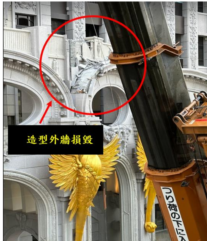
圖 1.6-9 位於低層樓之造型外牆受損
