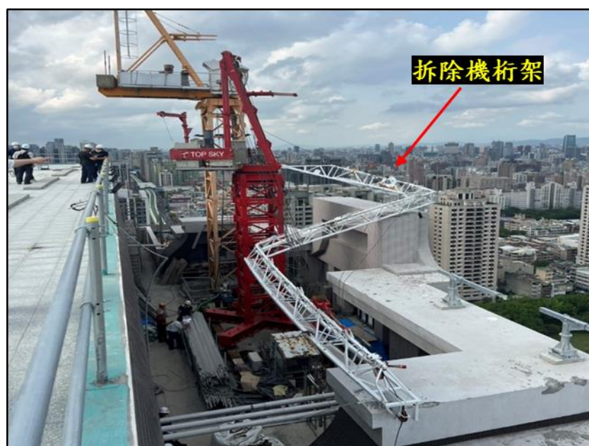
圖 1.1-10 拆除機桁架挫曲斷裂掉落於建築物頂樓
