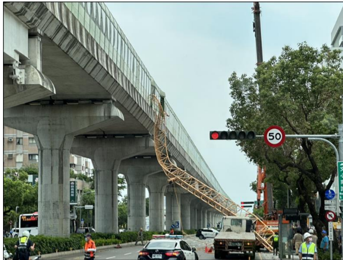
圖 1.1-1 斷裂墜落之桁架侵入捷運路線
