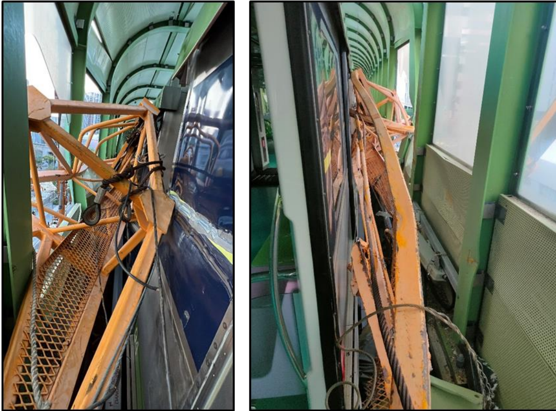
圖 1.3-3 塔式起重機桁架遭列車撞及後損害情形
