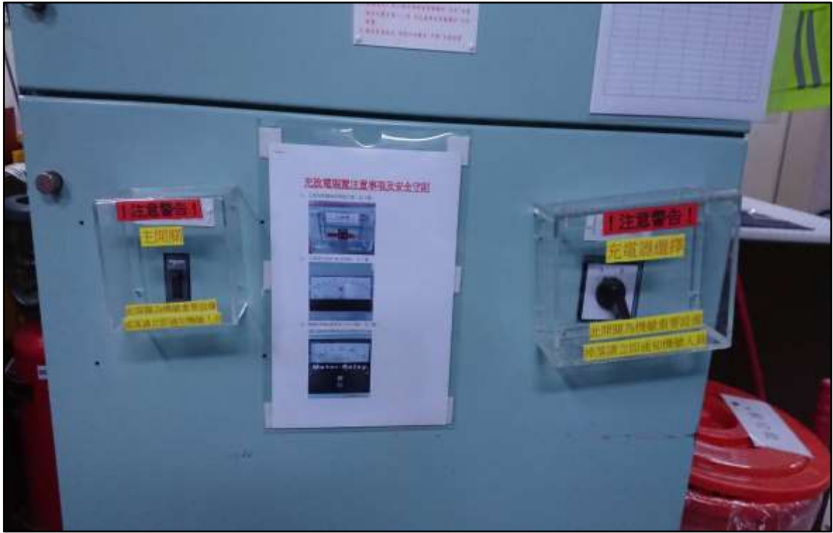
圖 25 充電盤電源開關加蓋保護
