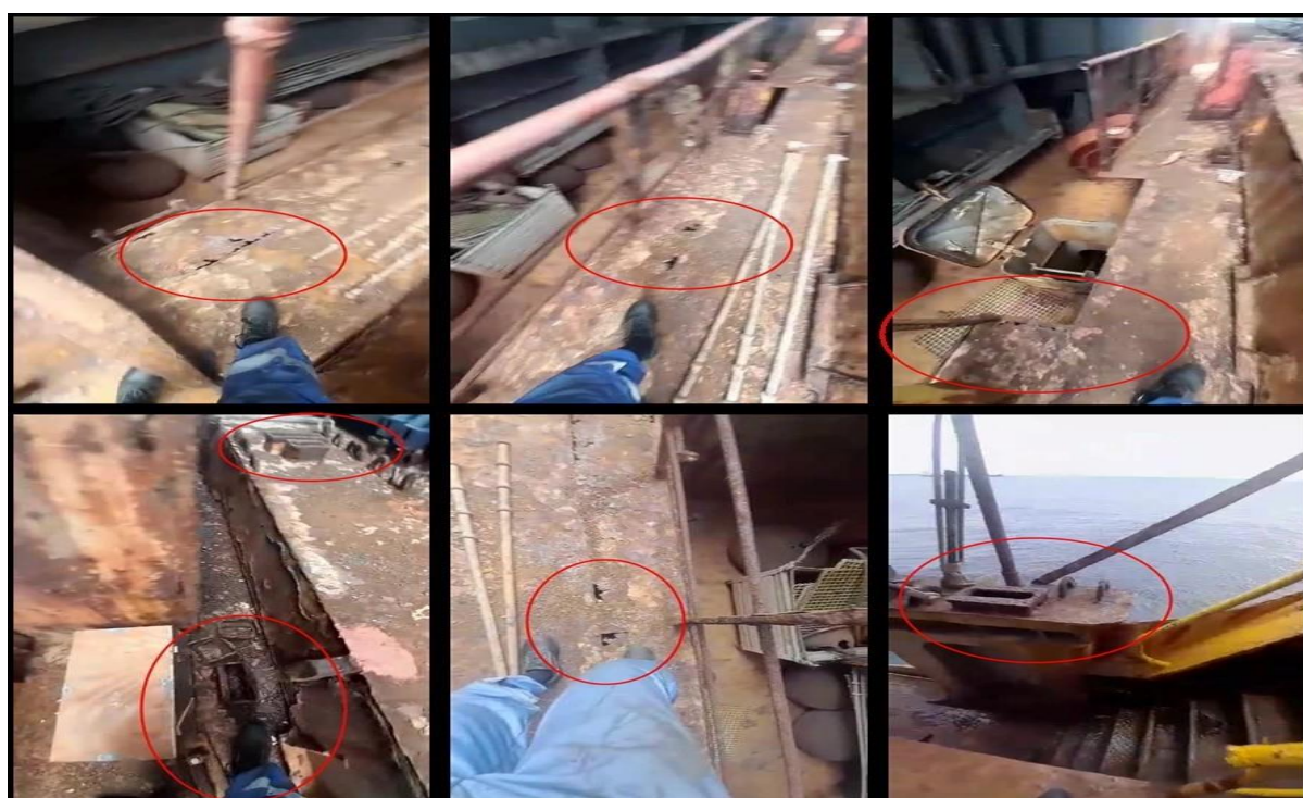
圖 1.11-2 天使輪主甲板存在破洞及鏽蝕照片
