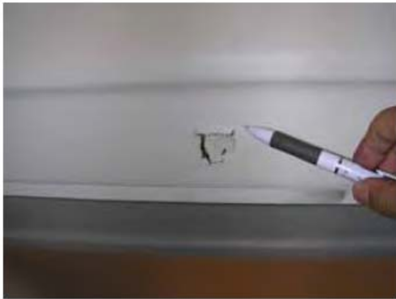
27A 天花板破裂
