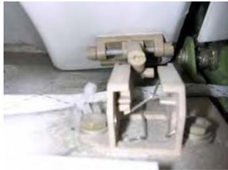
天花板固定座脫槽
