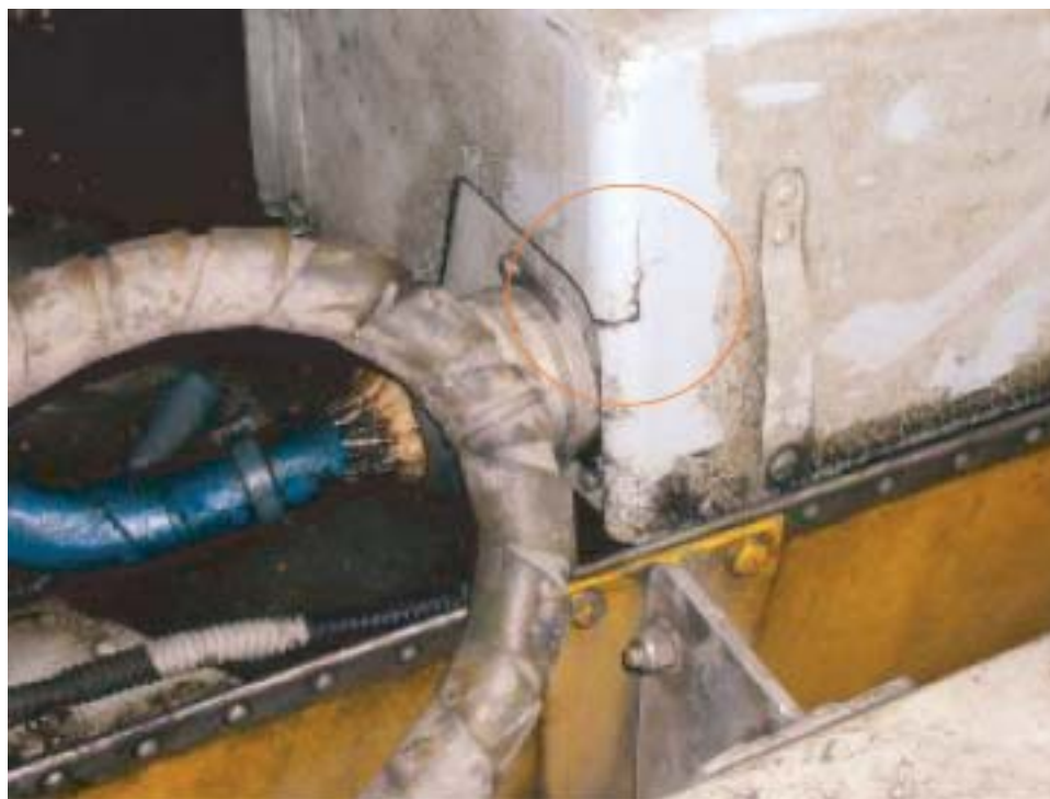
圖 1. 12. 4. 2-2 發電機接線箱
