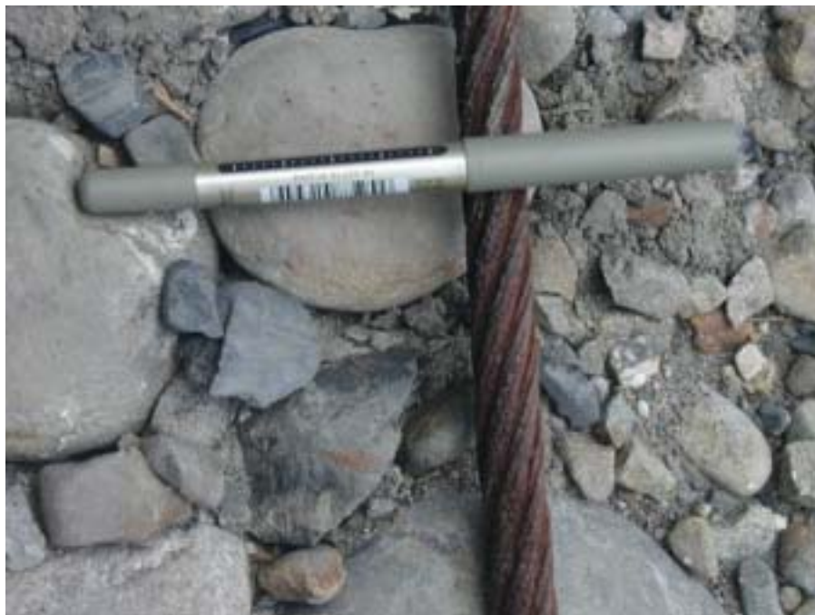
1.4-2 流籠鋼纜外表_蝕情形
