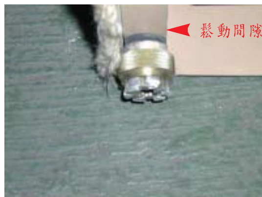
圖1.15-14 底座締緊螺栓鬆動
