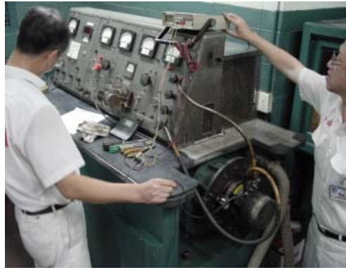
圖 1.16.1.5-1 發電機測試情形
