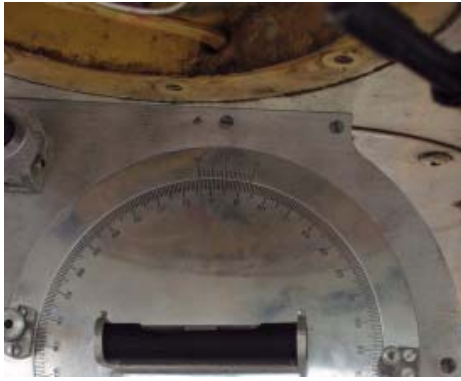
圖 1.18.1.2-8 測量後增壓泵水平
