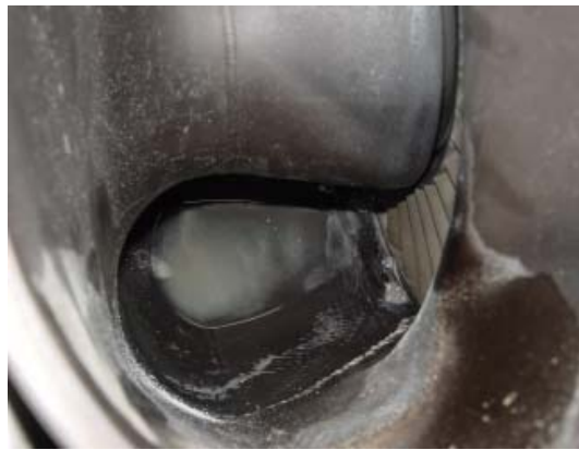
圖 1.12.1.2.2-2 發現排氣口有些許消防泡沫水積存
