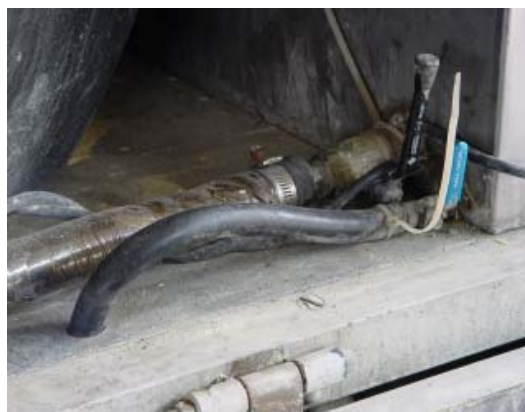
圖 1.17.2-2 直徑 1 吋之給油管及 1/2 吋之洩水管
