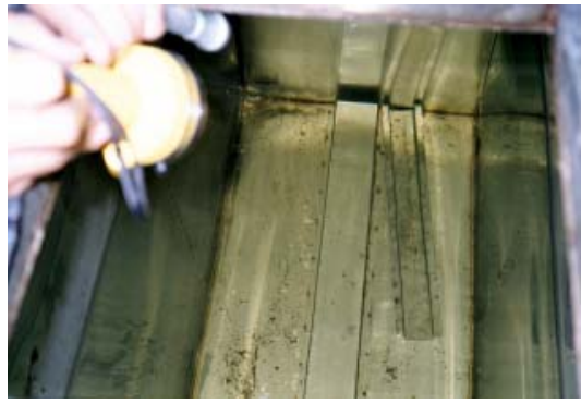
圖 1.17.2-4 給油管於油槽內部無立管設計
