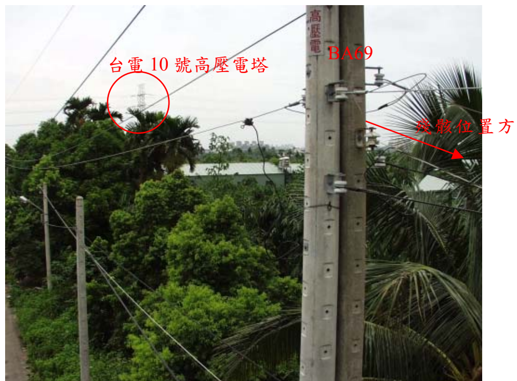
圖 1.12.2-6 自 BA69 電線桿旁台電 10 號高壓電塔
