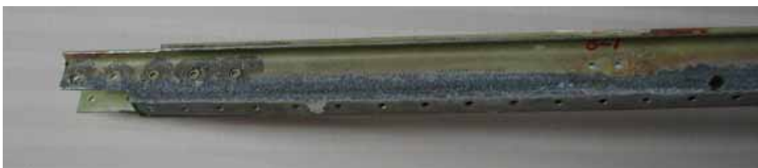
圖 1.12-34 G9-B 區腐蝕情形
