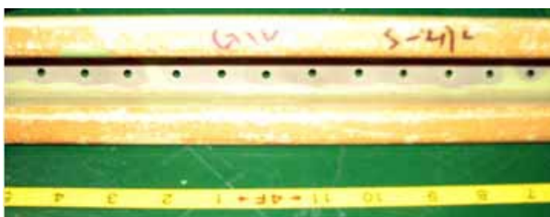
圖 1.12-44 G14 區腐蝕情形
