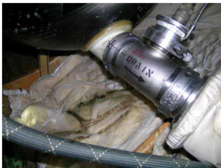
圖 1.12-5 隔熱棉污染痕跡
