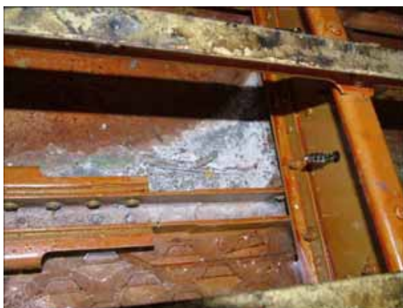
圖 1.12-2 (H) 站位 807 隔框後側蒙皮腐蝕細部照片
