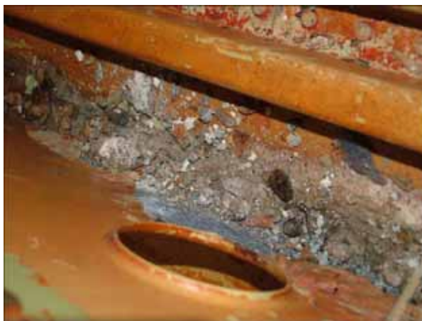
圖 1.12-2 (S) 縱向連接片腐蝕細部照片
