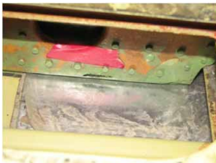
圖 1.12-49 肋間片貫穿性腐蝕
