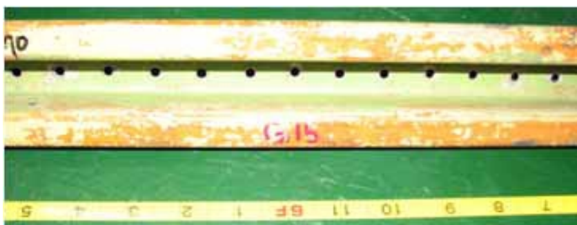
圖 1.12-46 G15 區, BS 958~BS 967 腐蝕情形
