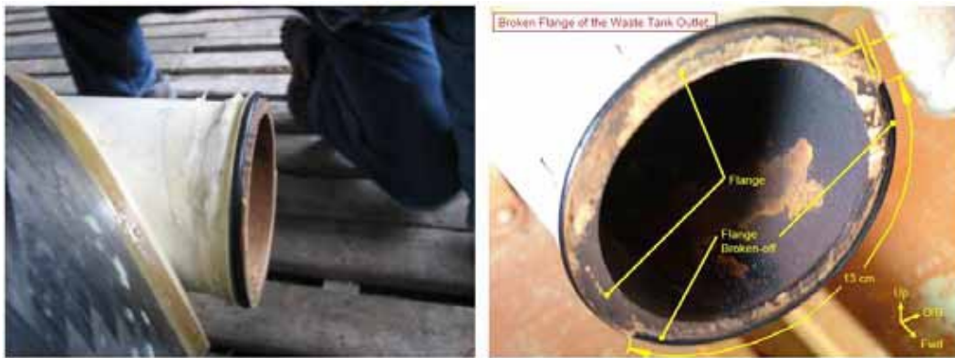
圖 1.12-9 廢水櫃出口管端凸緣損害情形
