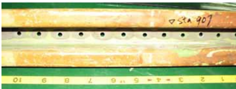
圖 1.12-42 G13 區, BS 907~BS 917 腐蝕情形
