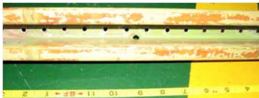
圖 1.12-48 G17 區腐蝕情形
