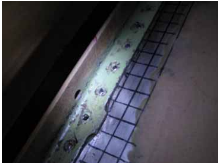
圖 1.12-32 G7 區腐蝕凹陷情形
