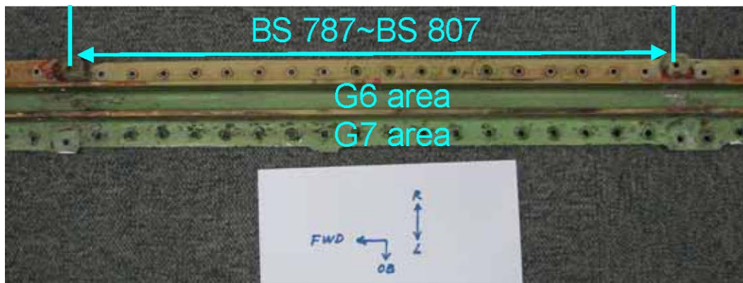
圖 1.12-31 G6、G7 區縱桁腐蝕情形
