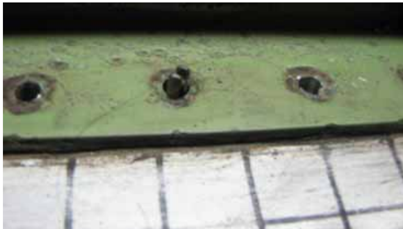
圖 1.12-30 G5 區腐蝕凹陷情形
