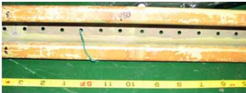
圖 1.12-45 G15 區, BS 947~BS 956 腐蝕情形
