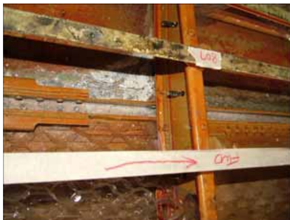
圖 1.12-2 (G) 站位 807 隔框後側蒙皮腐蝕照片
