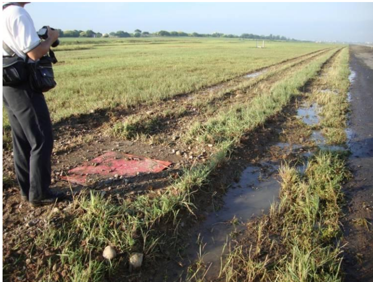
圖 1.10-9 地下式消防栓水泥結構周圍土壤凹陷
