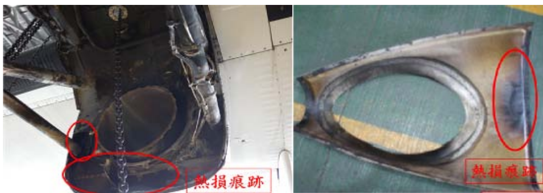
圖 1.14-3 機翼下箱型結構、整流罩遭受熱損
