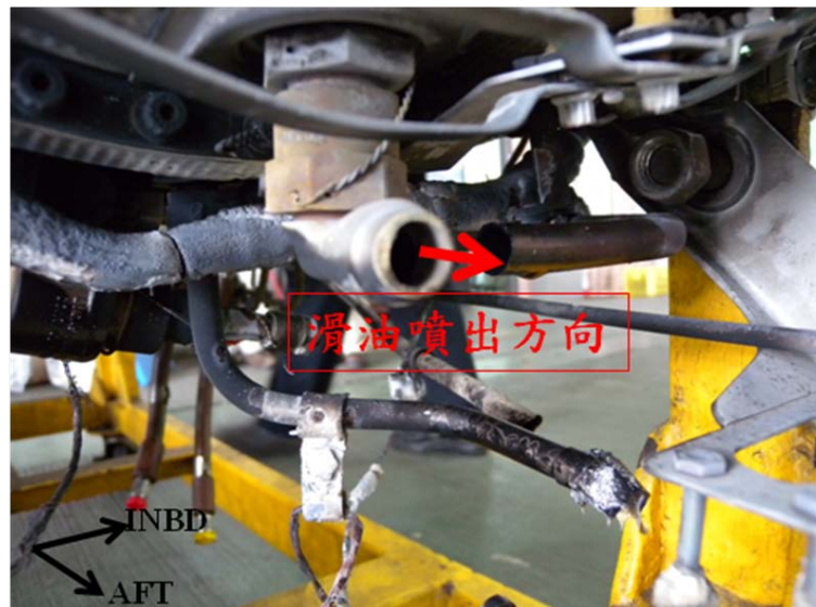
圖 1.14-7 6,7 號軸承滑油回油管斷裂口
