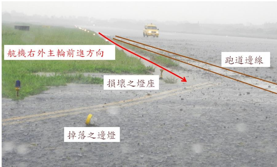
圖 1.12-2 損壞之跑道邊燈 (編號 RE-1-124)
