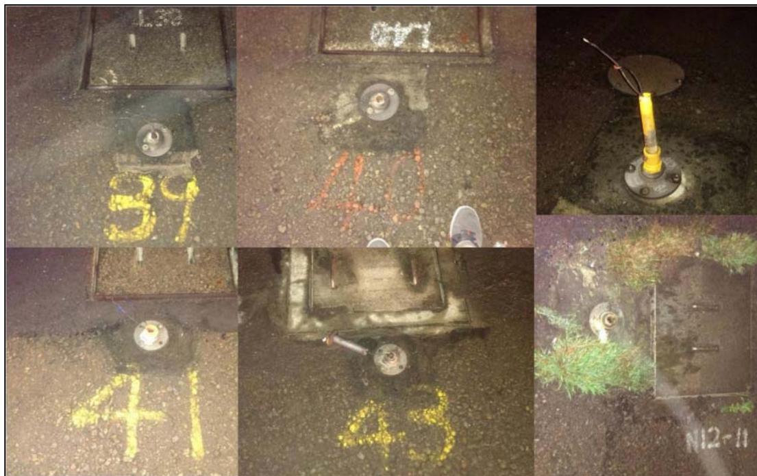
圖 1.12-4 損壞跑道邊燈及滑行道邊燈（桃機公司提供）
