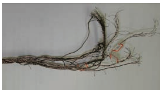
圖 1.16-11 B 段鋼索斷裂處 (ID9)
