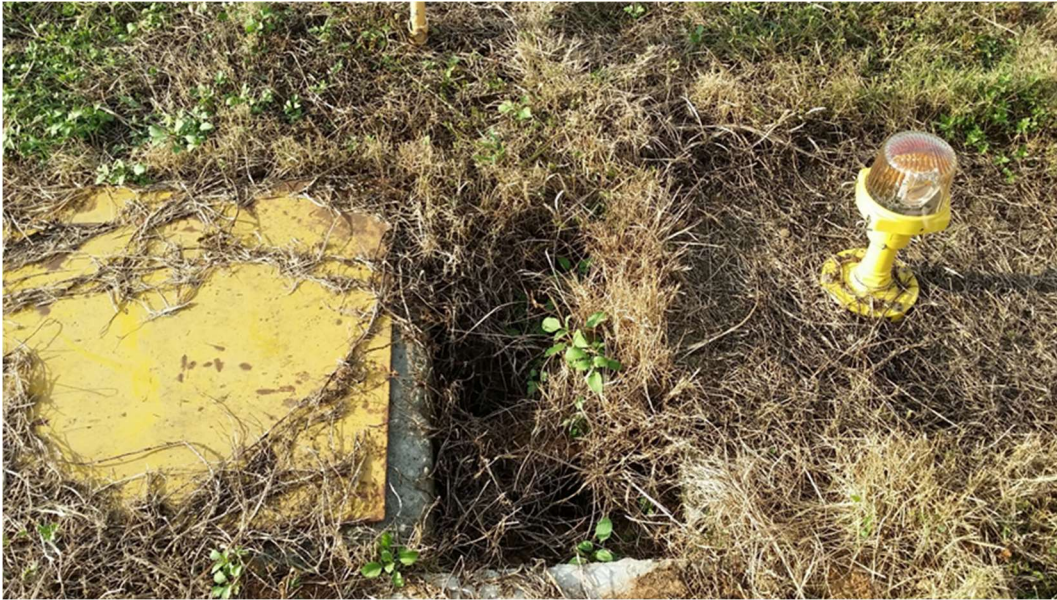
圖 1.10-3 跑道邊燈基座旁之坑洞照片
