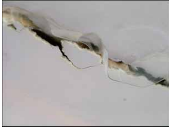
Figure 1.12-1 (D) Detail Cracked Skin External View
