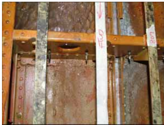
Figure 1.12-2 (D) Corrosion forward of Sta. 807
