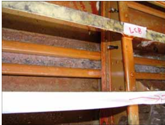
Figure 1.12-2(J) Corrosion aft of Sta. 827
