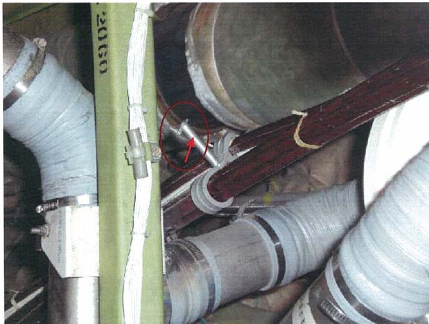
照片一、斷裂之電纜線支撐架（圈示處）的周圍環境及斷裂狀況
