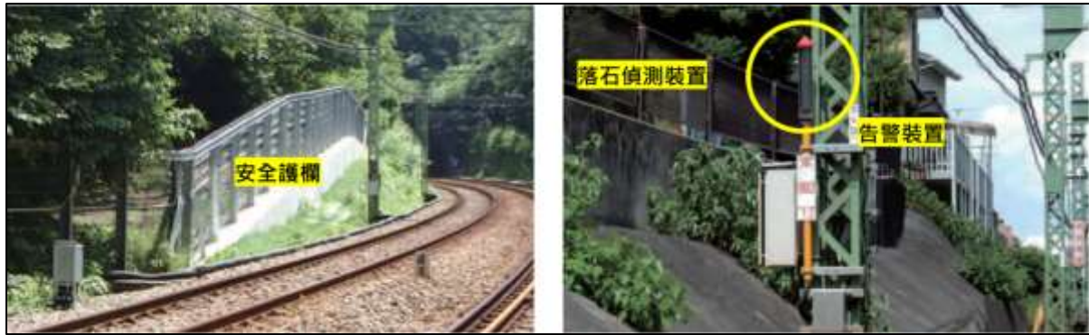
圖 1.7-12 京急電鐵安全護欄及落石偵測裝置 18
