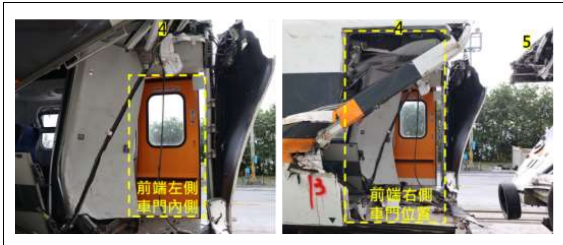
圖 1.13-2 第 4 車前端左、右側車門及玄關通道
