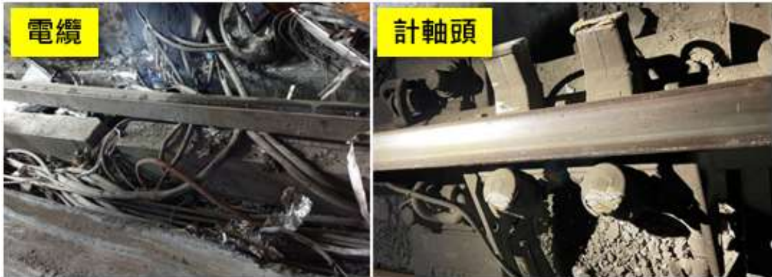
圖 1.3-16 電纜及計軸頭損壞情形
