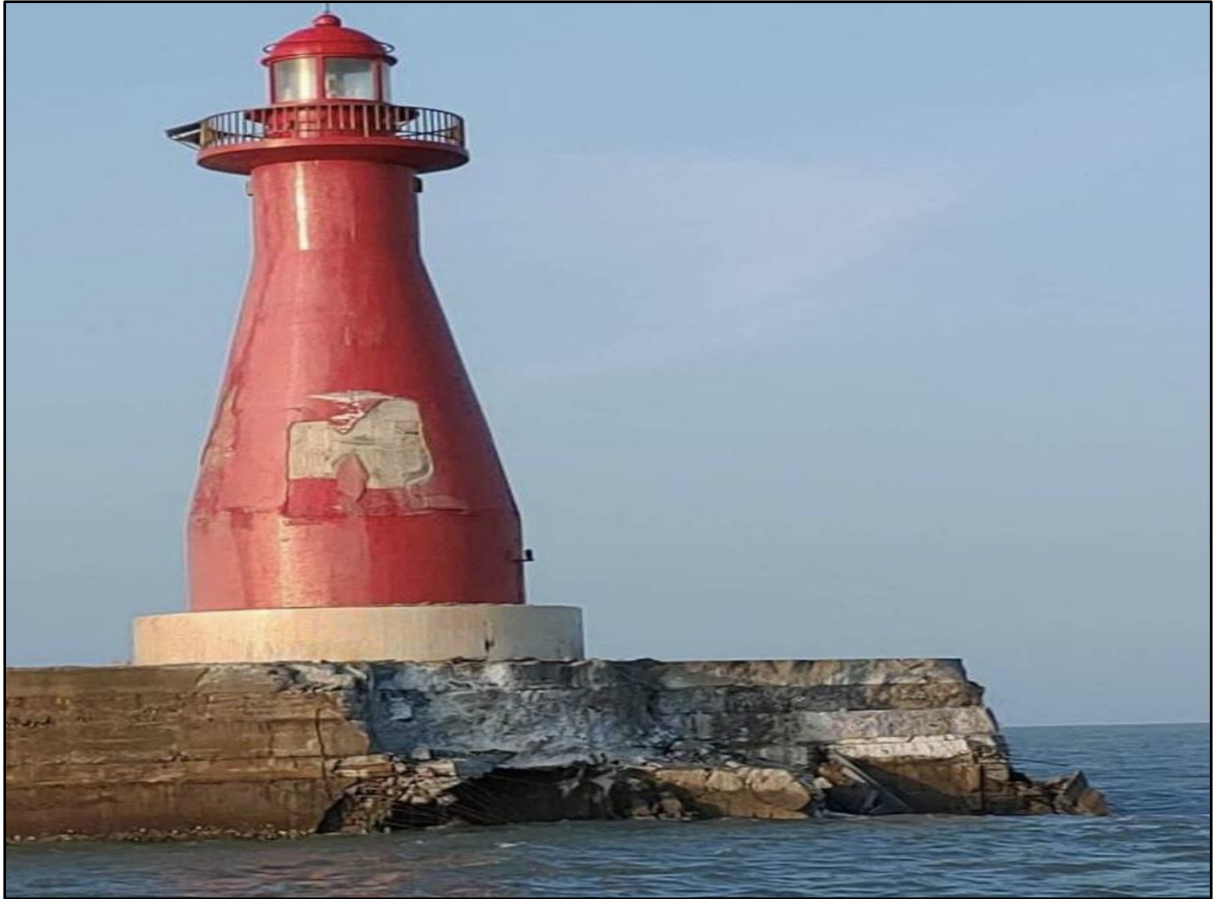
圖 2 南外堤及燈塔損害情形
