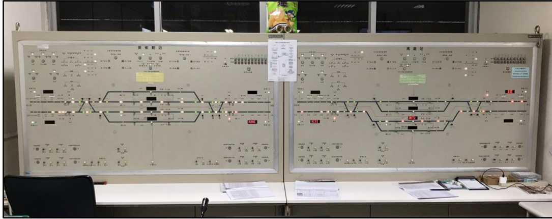
圖 1.11-4 高雄站行車室就地控制盤（含美術館站）
