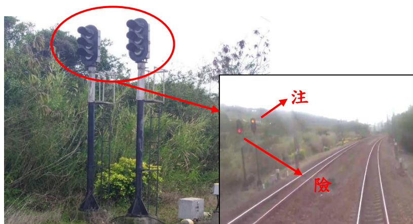
圖 1.1-3 通霄站北端進站號誌機（非事故當時拍攝）
