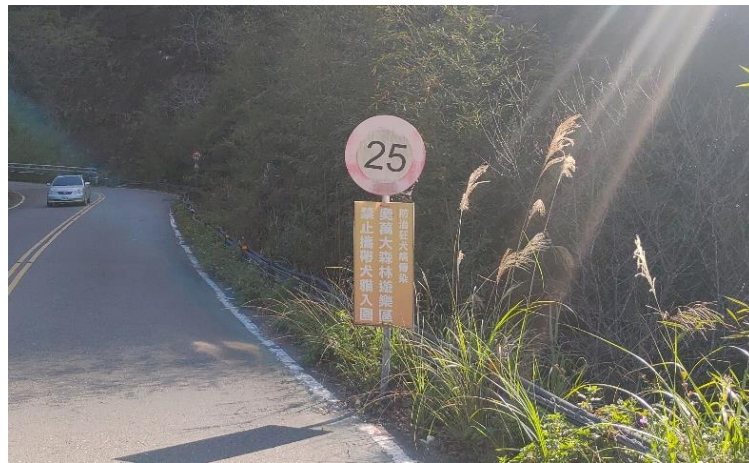
圖 1.8-4 速限標誌有明顯退色情形
