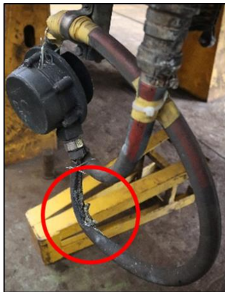
圖 1.3-3 轉速計電線燒損情形
