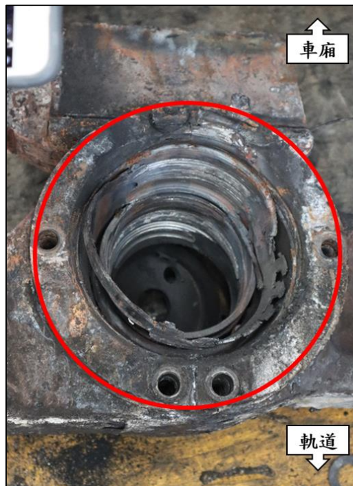
圖 1.3-6 軸承損害情形
