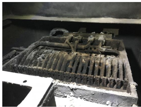
本事故燒損電抗器
