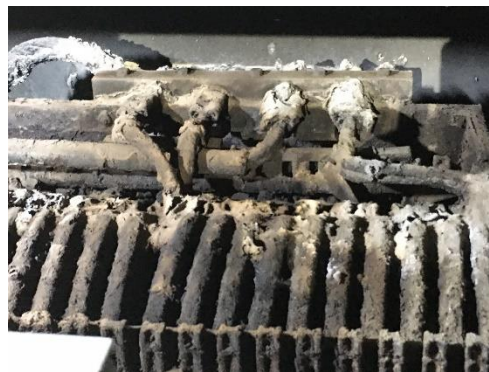
本事故燒損電抗器
