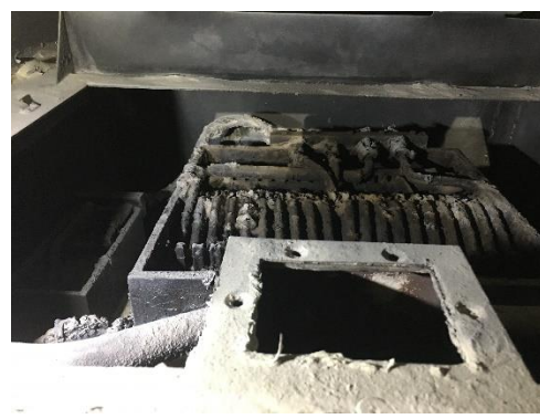
本事故燒損電抗器
