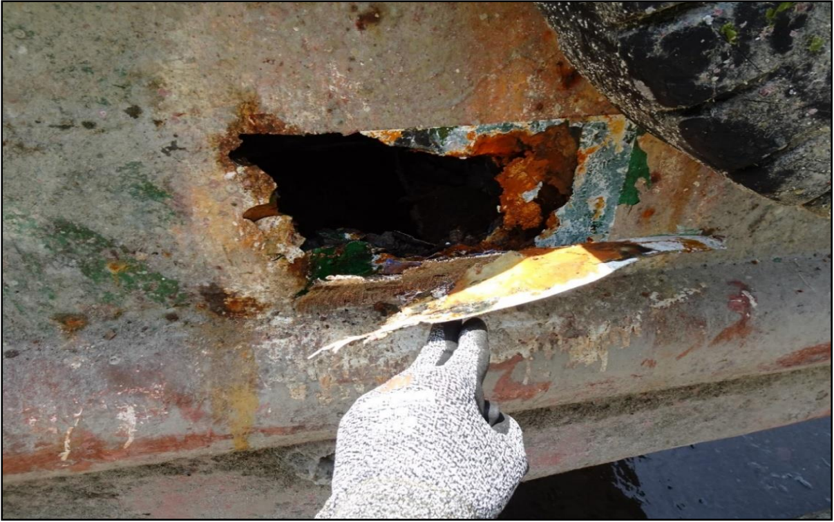
圖 26 東洋 6 號左船艙移除修補膠布外觀圖 (約 25 公分 X15 公分)
