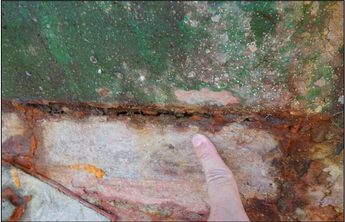
圖 22 東洋 6 號船艙船殼鋼板，多片修理鄰接處有明顯裂縫
