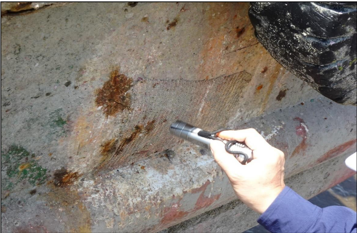
圖 25 東洋 6 號左船艙存在膠布修理痕跡
