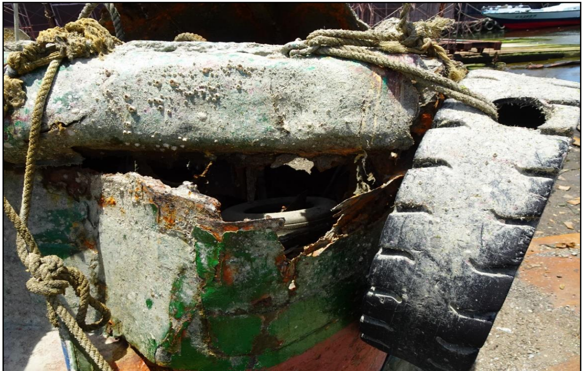
圖 21 東洋 6 號左船艙船殼破損（約 40 公分 X 20 公分）
