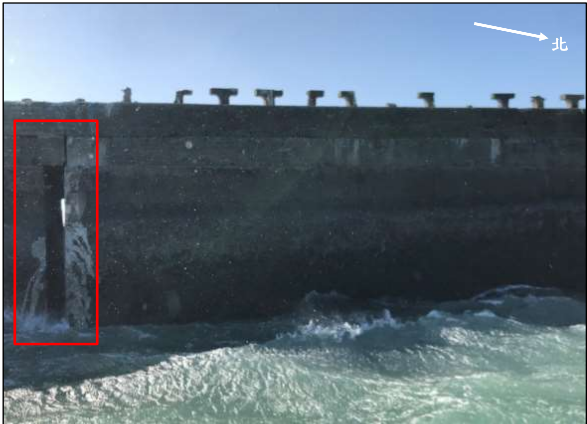
圖 2 南外防波堤損壞情形
