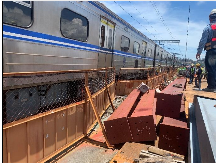
圖 2 事故現場狀況
