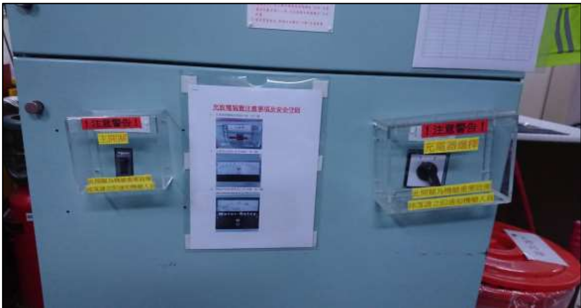
圖 25 充電盤電源開關加蓋保護
