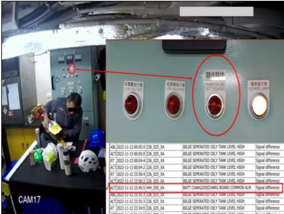
圖 13 充電盤電源失效燈亮及機艙警報
