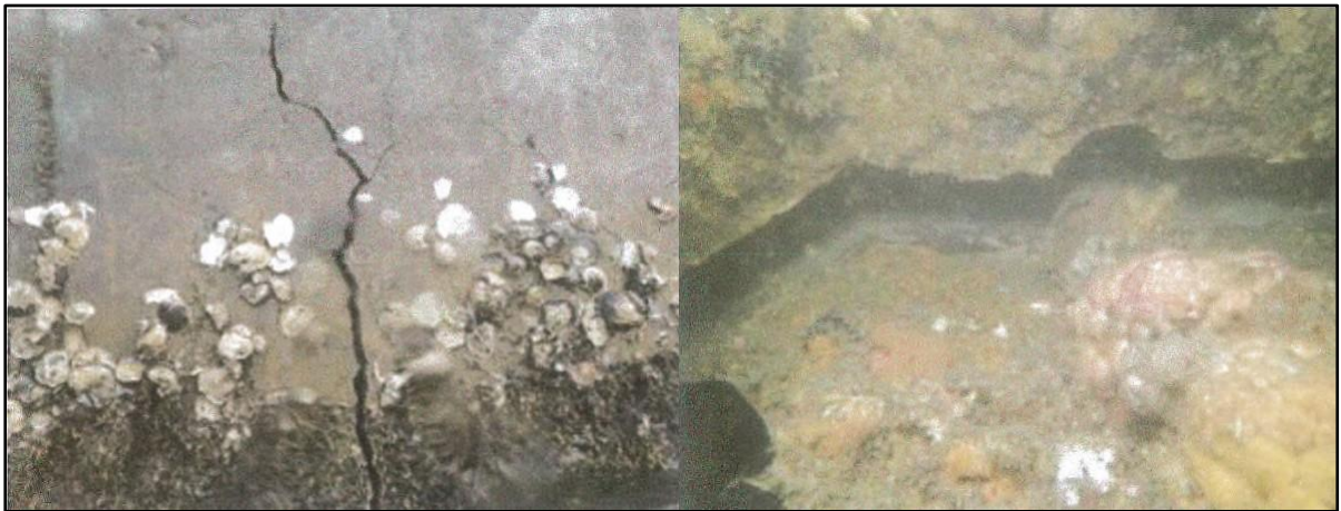
圖 5 水下冠牆面破裂
