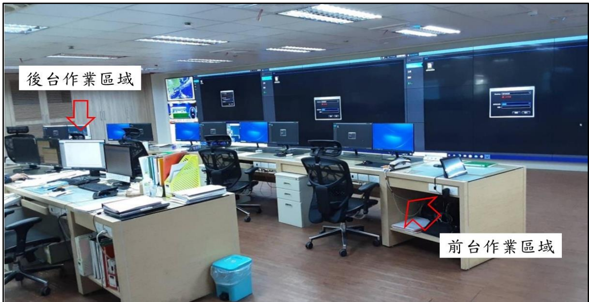
圖 1.8-4 臺中港監控中心前後臺現場環境示意照片
