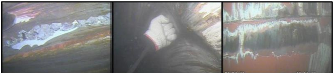
圖 10 左舷 78 至 84 號肋骨舭列板裂縫、凹陷及刮痕
