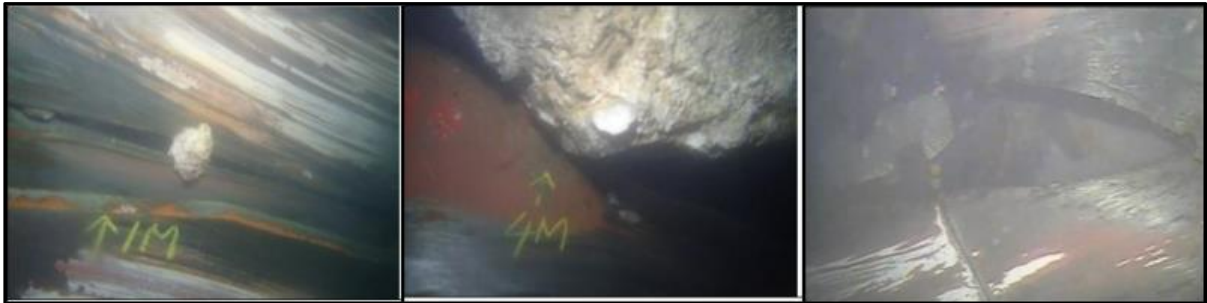
圖 8 右舷 83 至 88 號肋骨舭列板裂口
