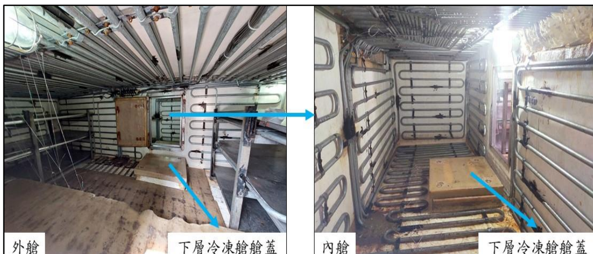
圖 3 冷凍艙內部照片
