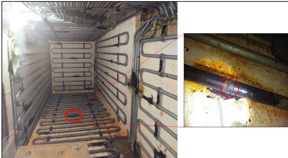
圖 4 冷凍艙蒸發盤管裂縫
