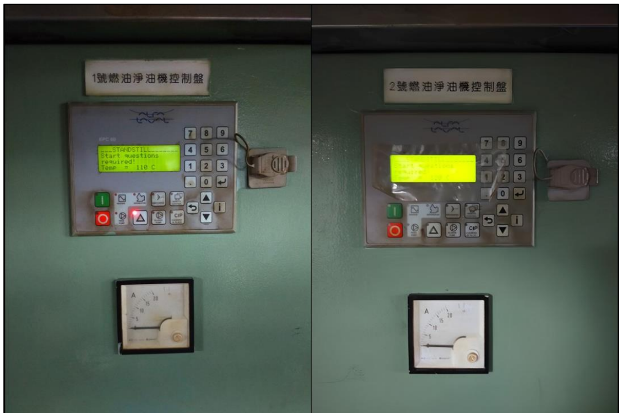
圖 17 燃油淨油機控制面板資訊
