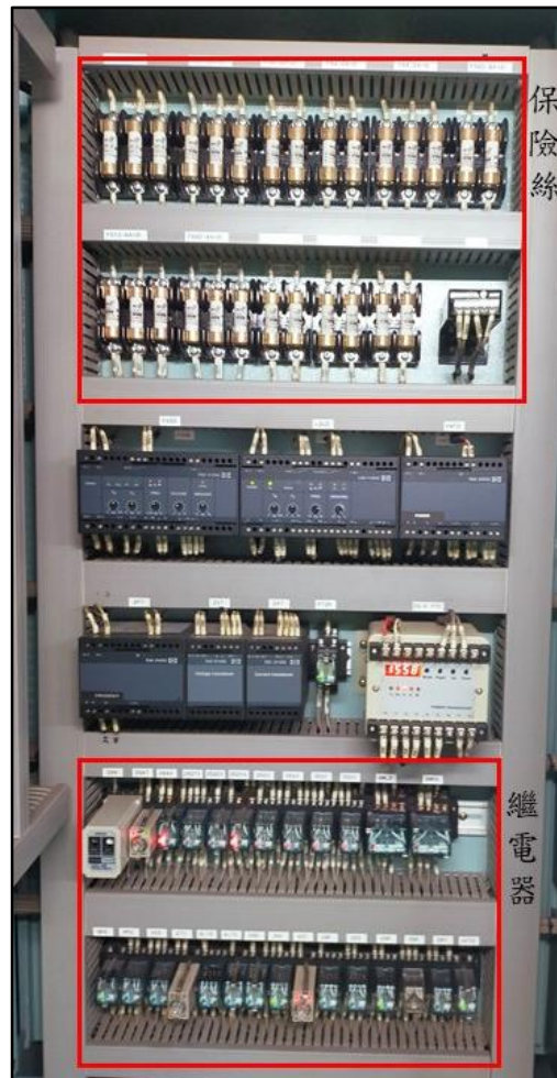
圖 8 主配電盤保險絲與繼電器
