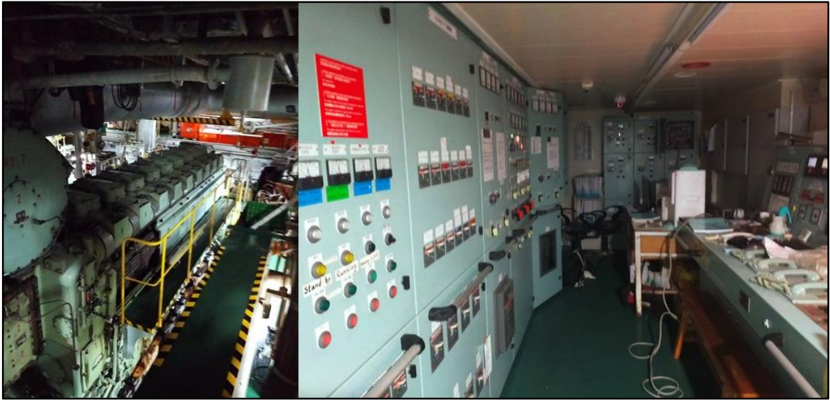
圖 6 機艙緊急照明
