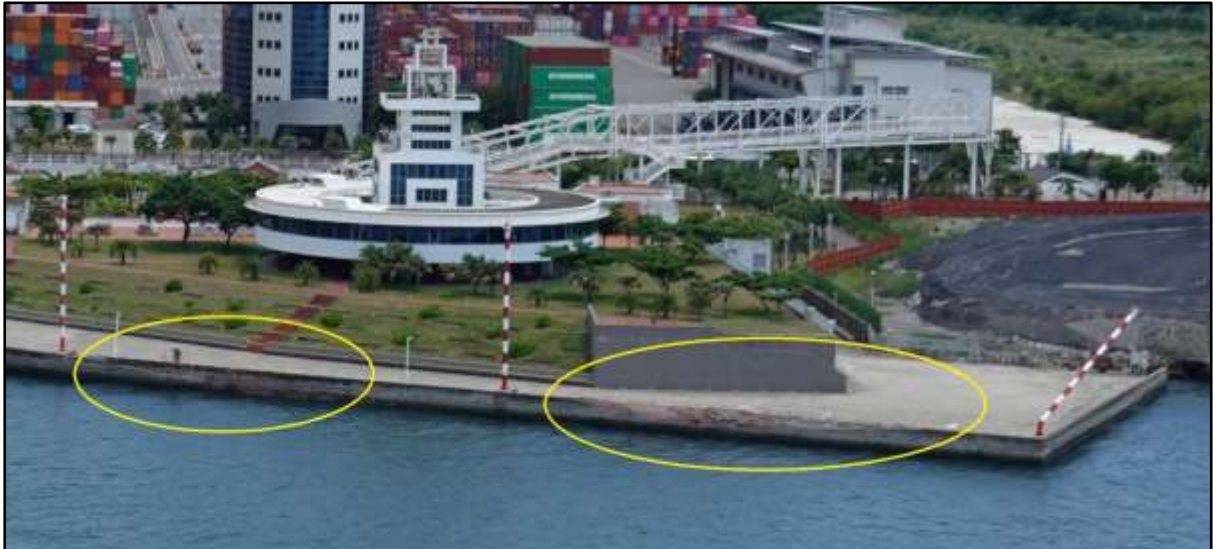
圖 4 二港口南護岸損壞部分
