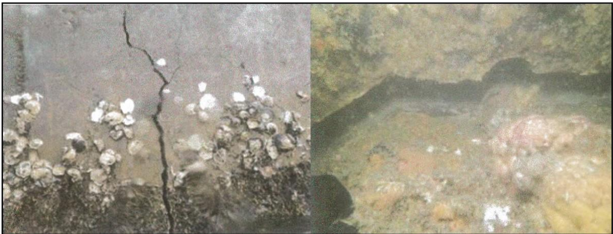
圖 5 水下冠牆面破裂
