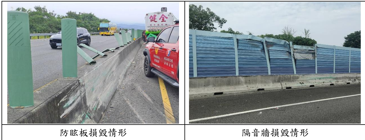
圖 1.4-2 道路設施損毀情形
