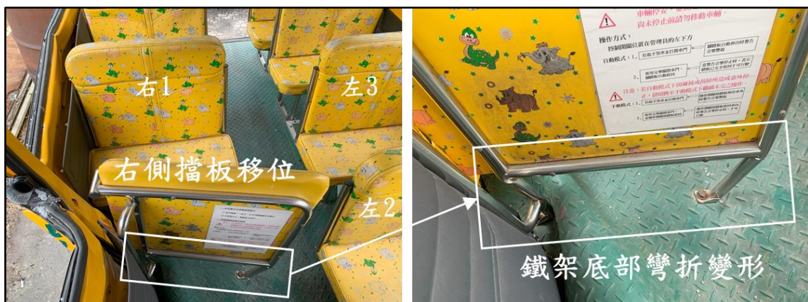
圖 1.3-5 右側擋板受損情形
