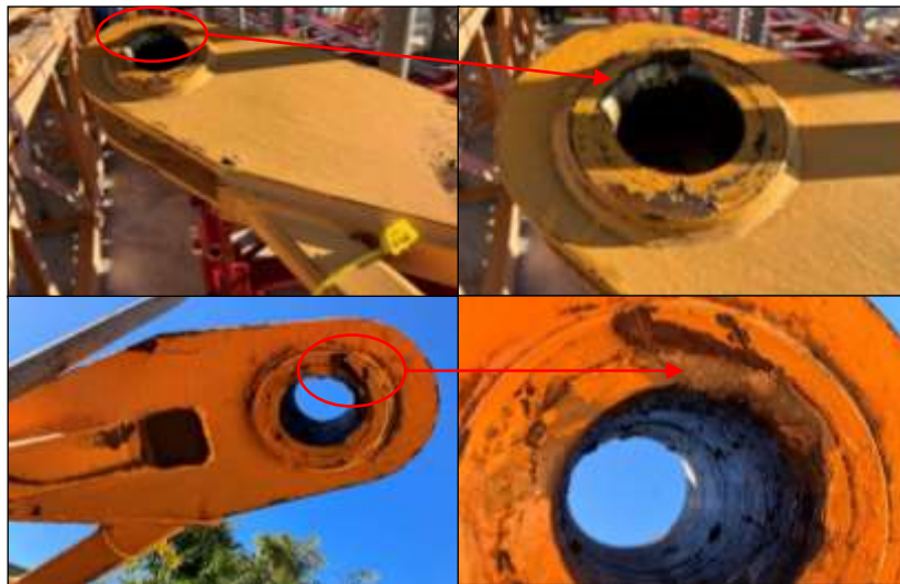
圖 1.3-16 桁架第 1 節左根部（靠駕駛側）擠壓變形
