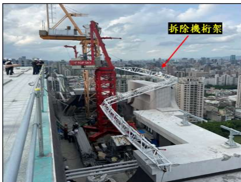
圖 1.1-11 拆除機桁架挫曲斷裂掉落於建築物頂樓
