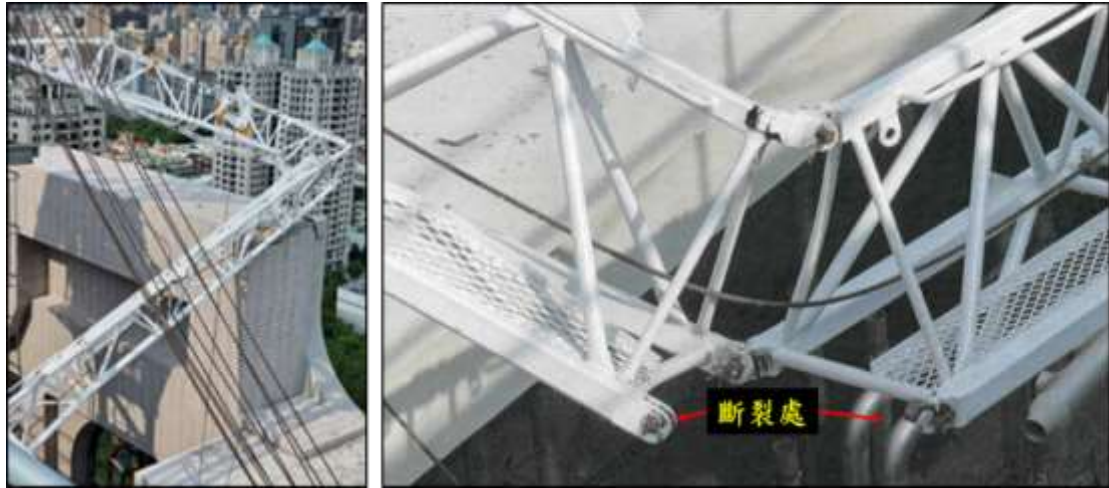
圖 1.3-2 拆除機桁架斷裂情形 7
