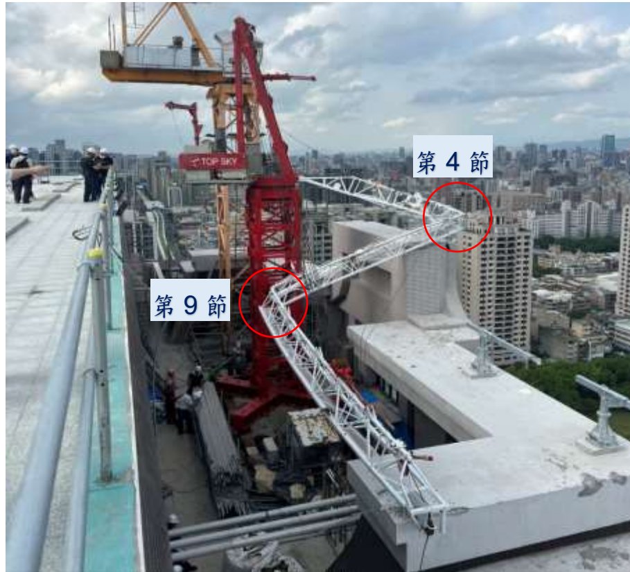
圖 1.3-5 事故現場拆除機桁架墜落位置
