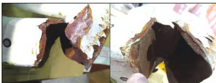
圖 1.18-1 第 4 節弦桿斷裂處
