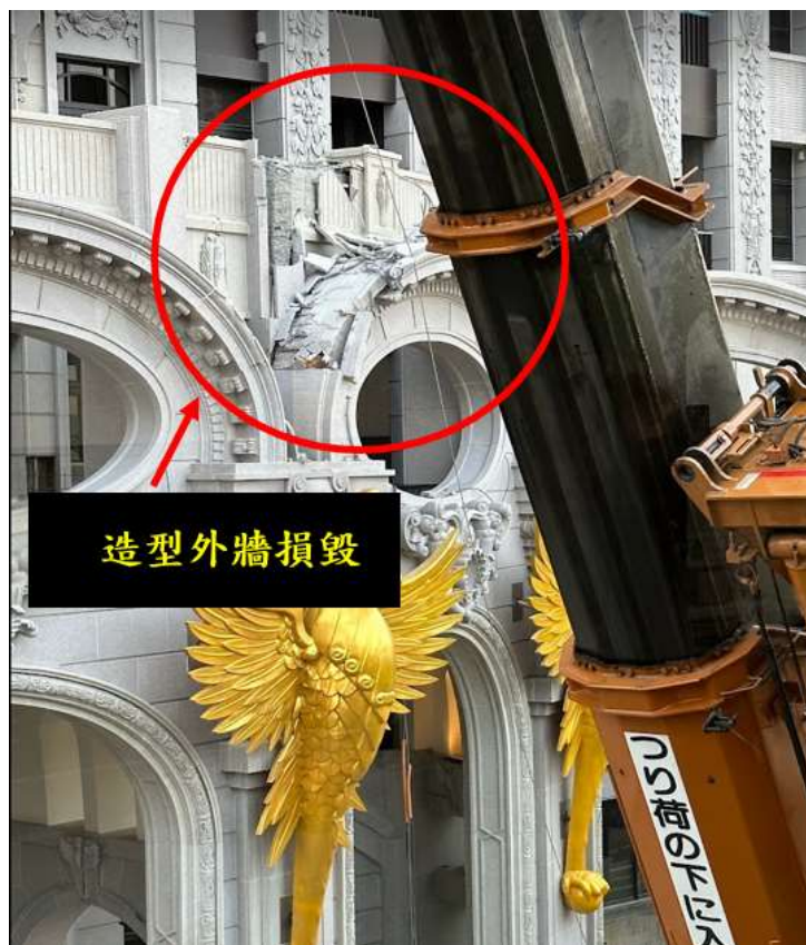
圖 1.1-13 位於低層樓之造型外牆受損
