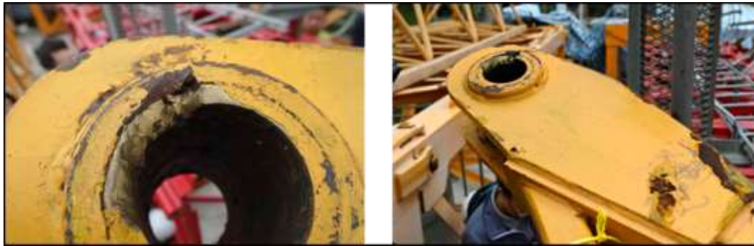
圖 1.3-3 塔式起重機桁架根部損害情形（非事故當日拍攝）
