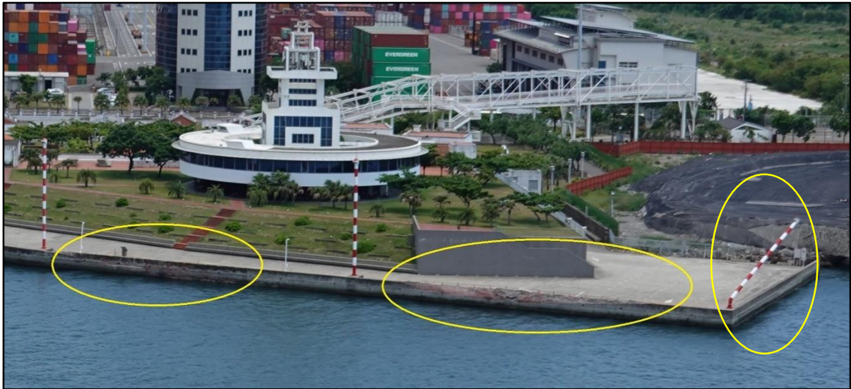
圖 4 二港口南護岸損壞部分
