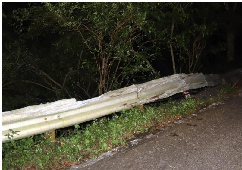
圖 1.4-1 對向車道護欄損害情況
