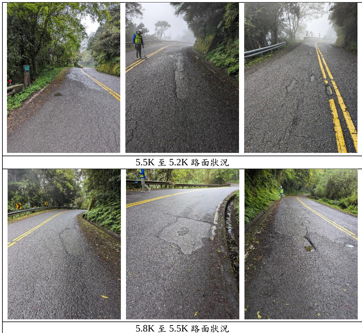
圖 1.8-3 事故路段路面狀況
