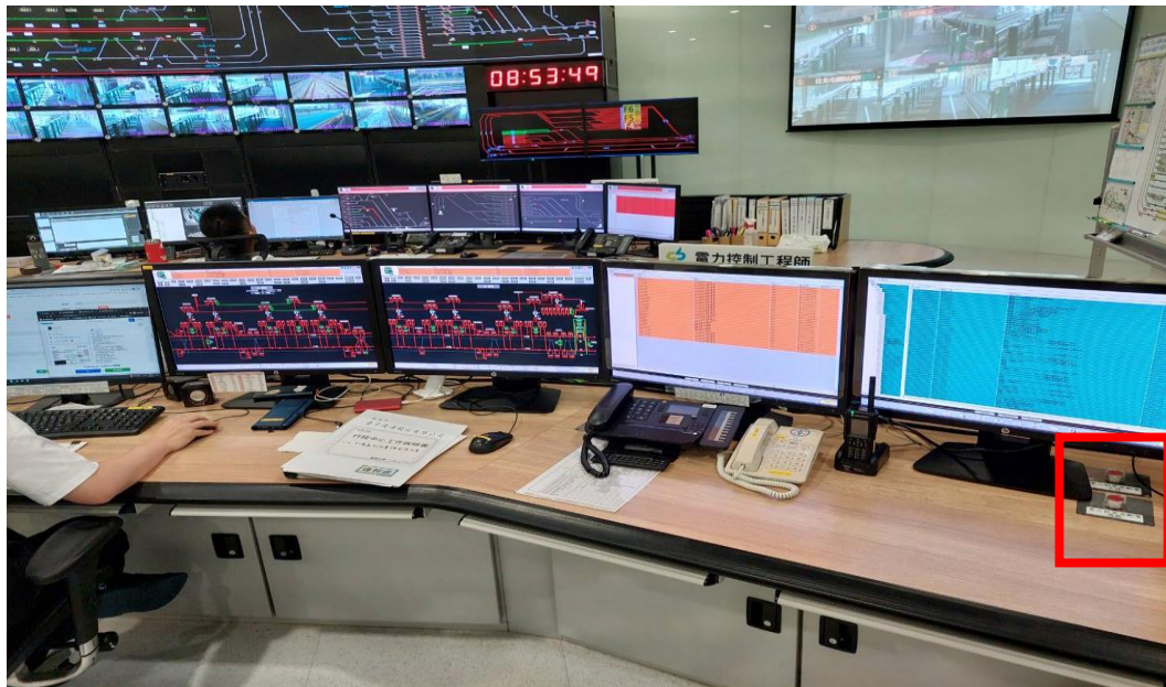
主線與機廠第三軌緊急斷電按鈕設置位置
