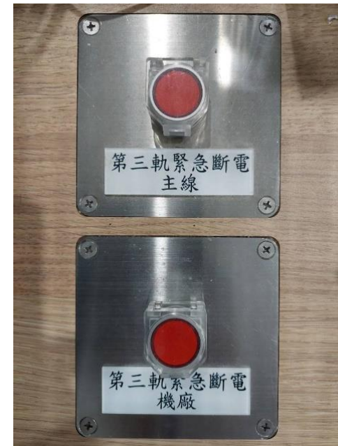
主線與機廠第三軌緊急斷電按鈕
