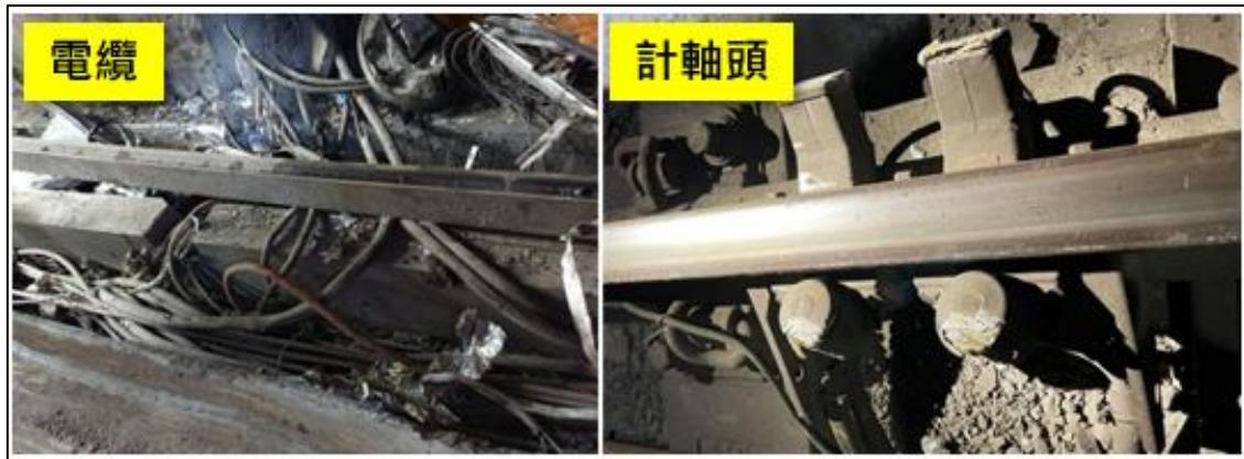
圖 1.3-16 電纜及計軸頭損壞情形
