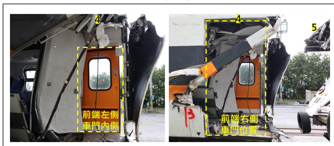
圖 1.13-2 第 4 車前端左、右側車門及玄關通道
