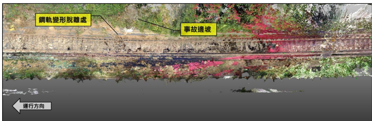
圖 1.11-14 鋼軌變形脫離狀況
