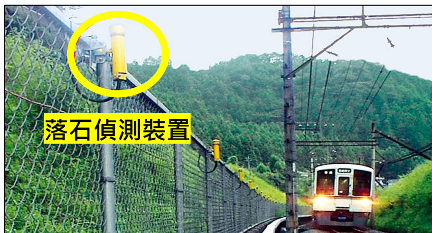
圖 1.7-11 西武鐵道落石偵測告警裝置 16
