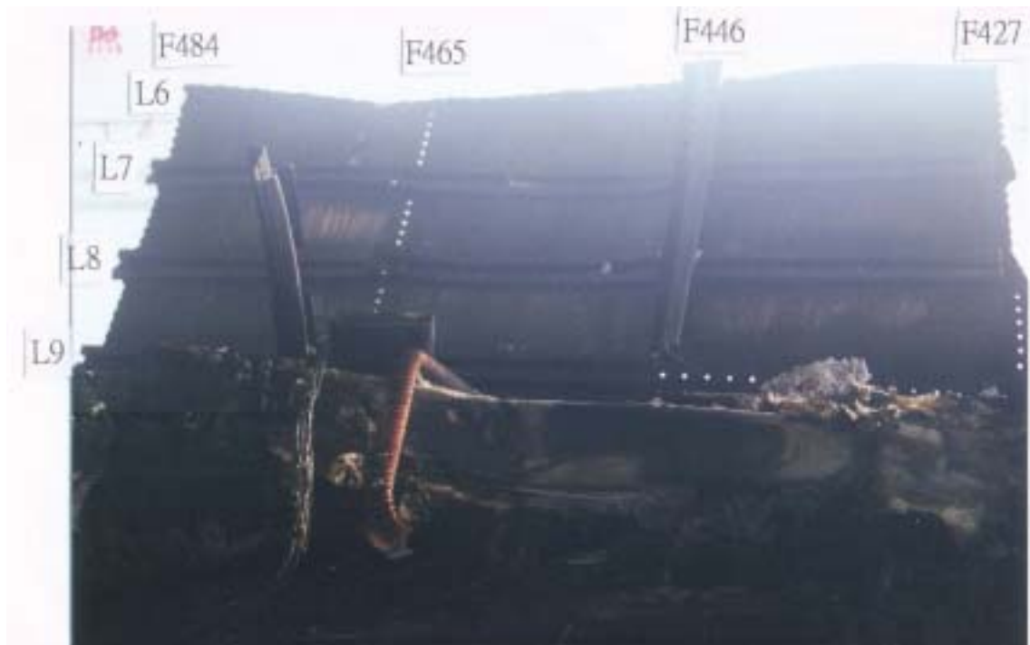
圖1.12-7 空調導管破損並自下向上燒灼痕跡
