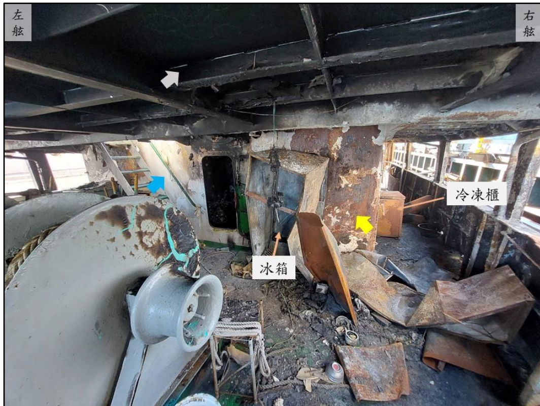
圖 1.4-13 後甲板住艙側損害情況
