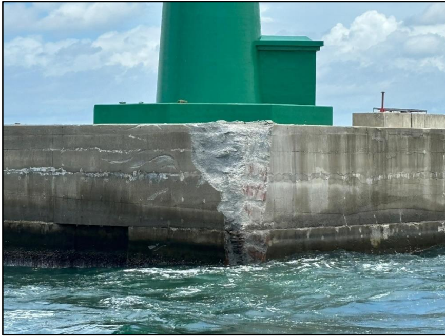
圖 1.3-5 離岸堤受損照片
