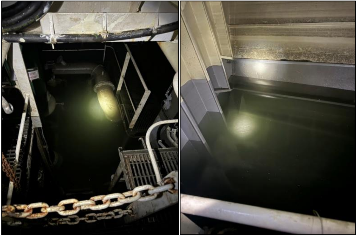
圖 1.3-3 「通運」泵間內部浸水照片
